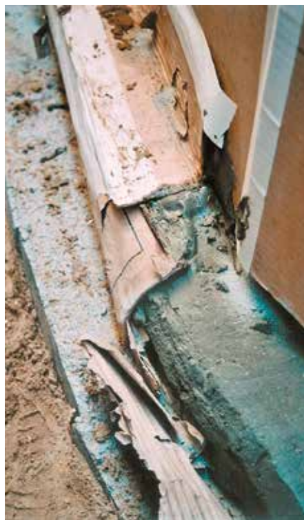
Misslungene Bentonitabdichtung am Fundamentübergang (Foto: CRP Bauingenieure)
